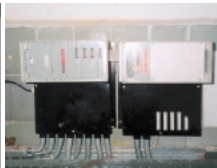
Два контроллера заменили старую систему управления тепловым пунктом
